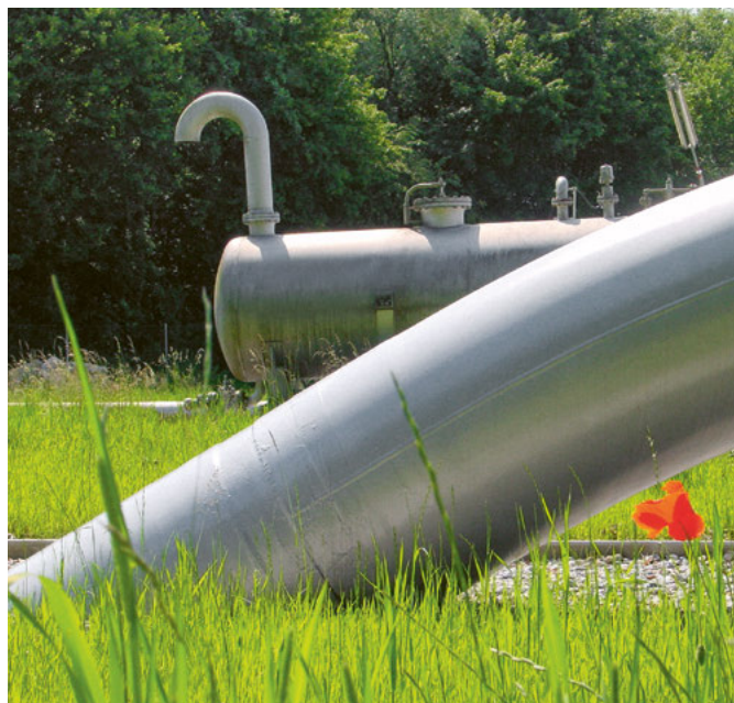
Swiss Gas Invest SA contribue à l'approvisionnement en gaz naturel de la Suisse. La station de mesure de Wallbach constitue l'un des points d'entrée de cette énergie sur le sol helvétique.
