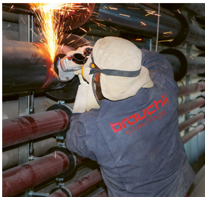
Brauchli SA a réalisé toutes les installations de chauffage et de rafraîchissement dans l'Institution de Lavigny, comprenant l'assainissement d'équipements et de réseaux de conduites existants et la réalisation de nouvelles installations.
