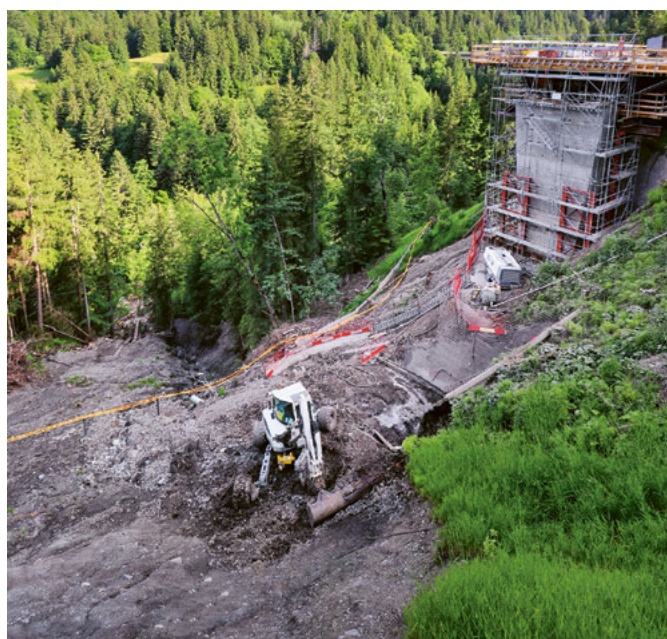
Les équipes de la Société du Gaz de la Plaine du Rhône SA ont posé des conduites flexibles provisoires permettant de maintenir l'alimentation en gaz des clients de Gryon durant les travaux de construction du nouveau pont de l'avenue d'Arveyes.
